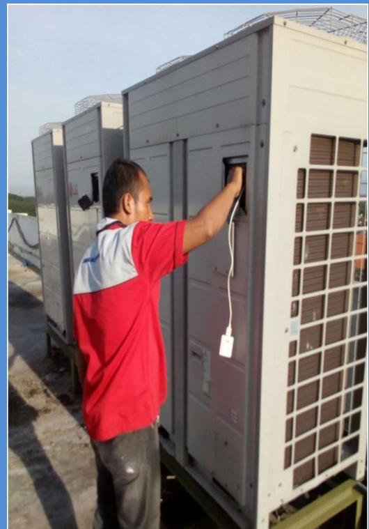
MAINTENANCE AC DI RSUD SUKODONO MADIUN
