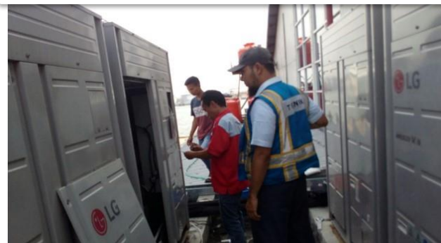
MAINTENANCE AC DI PELINDO III EMAS SEMARANG
